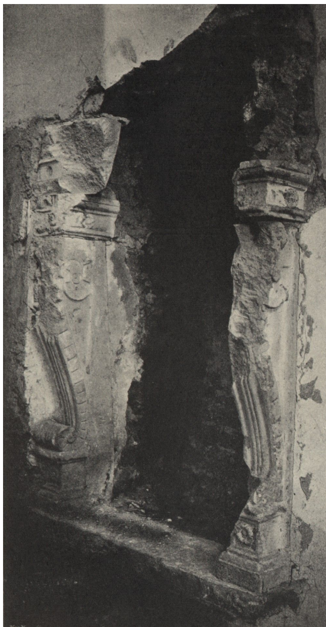
Fig. 10. Korzkiew, zameczek, pozostałości z kominka. Fot. autora.
